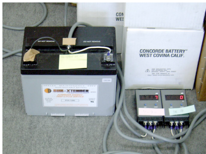
写真2 バッテリー・直流電力積算計
